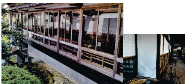
被災後の和倉御便殿供養殿と内装
